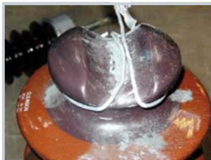
Skutki braku ochrony powierzchni izolatora przy mocowaniu przewodu wiązałką ręczną
