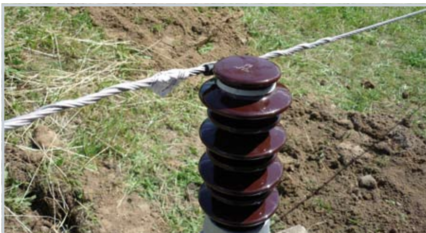
Zawieszenie przelotowe przewodu uchwytem oplotowym bocznym GFST.
