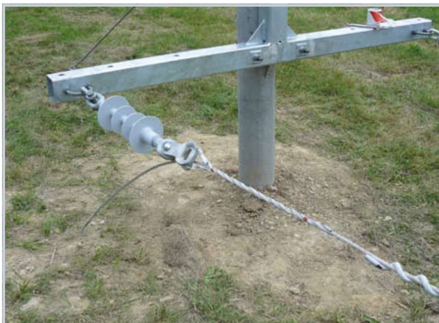
Mocowanie przewodu w linii SN na słupie odporowym uchwytem oplotowym odciągowym DDE.
