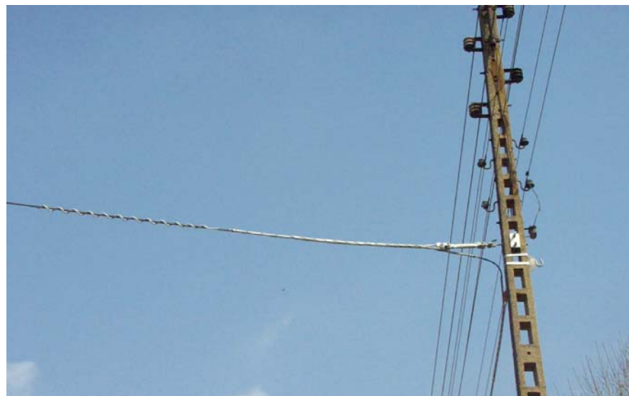
Rys. 4. Spiralny tłumik drgań na linii napowietrznej przy uchwycie odciągowym
